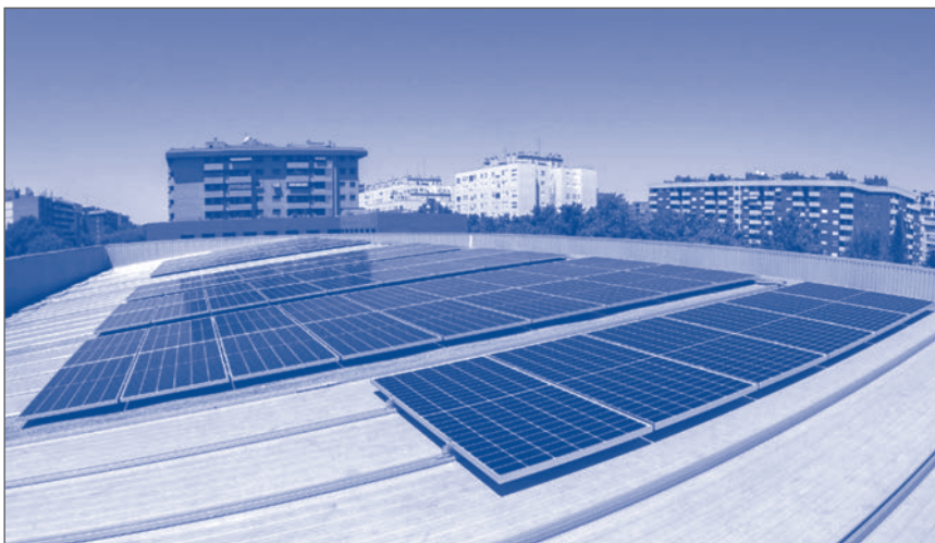
Instalación de autoconsumo colectivo en Zaragoza (ECODES).
